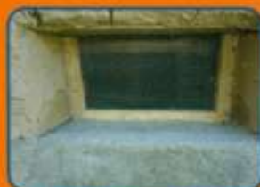
3. Canal de ventilación
